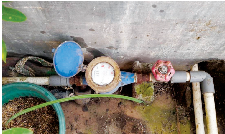
Gambar 2.5 Distribusi Air Menggunakan Water Meter
