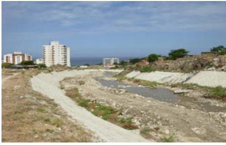
Canalización inconclusa y ya sedimentada, río San Julián
