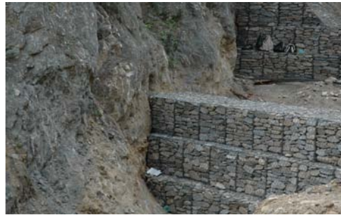
Insuficiencias de anclajes en presas de gaviones
