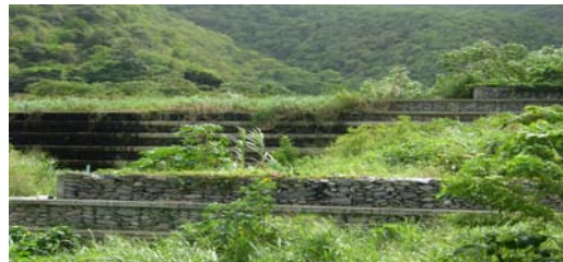
Presas de Macuto con vegetación y sedimentos acumulados
