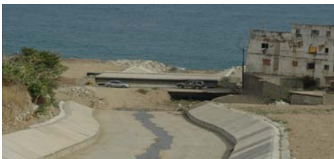
Canalización quebrada El Cojo inconclusa
