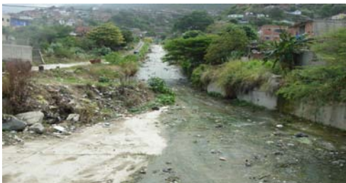
Situación de la canalización en Guanape, con ausencia de mantenimiento
