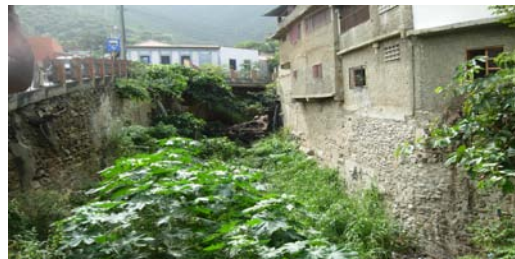
Quebrada Osorio, sin canalizaciones
