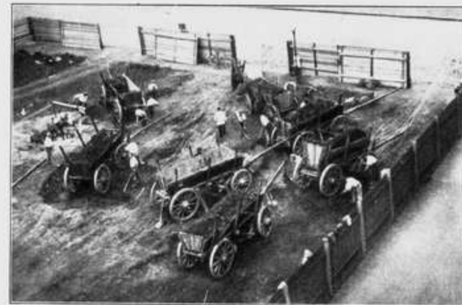
Die ersten Ausschachtungsarbeiten. Das Loch in der Mitte gibt über günstige Grundwasserverhältnisse Aufschluß.
