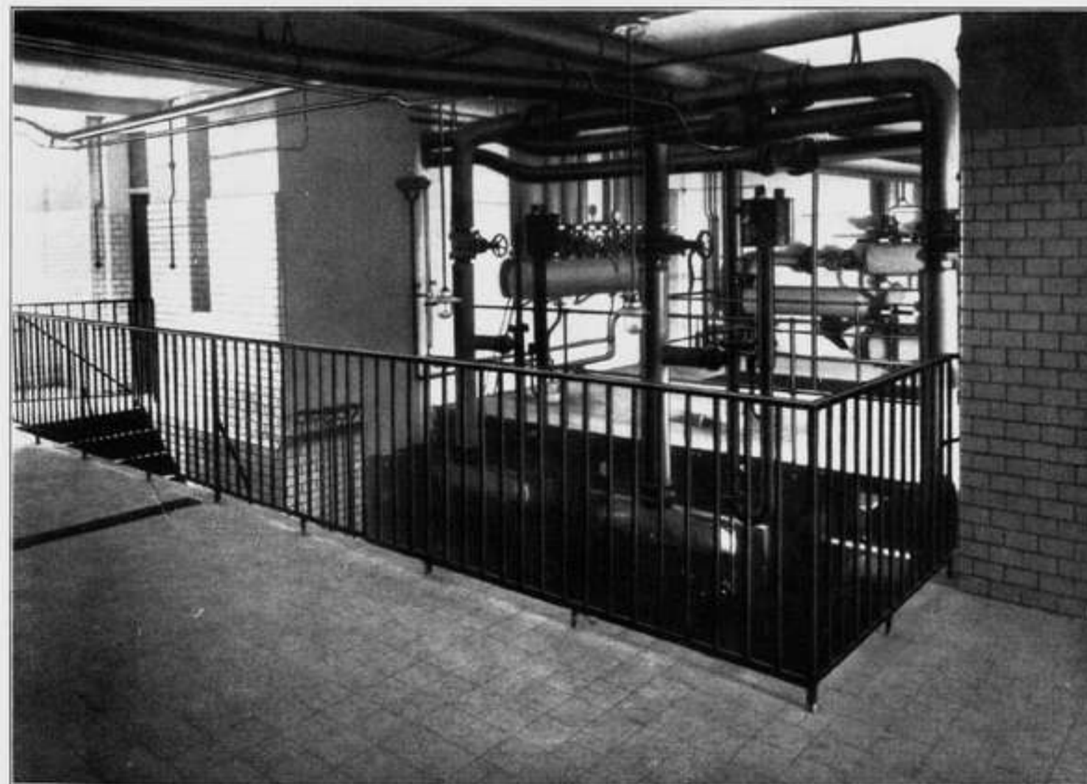
Die Heizungsanlagen mit drei Kesseln, die für Erwärmung des Hauses, der Übungshallen und des Schwimmbades zu sorgen haben.
