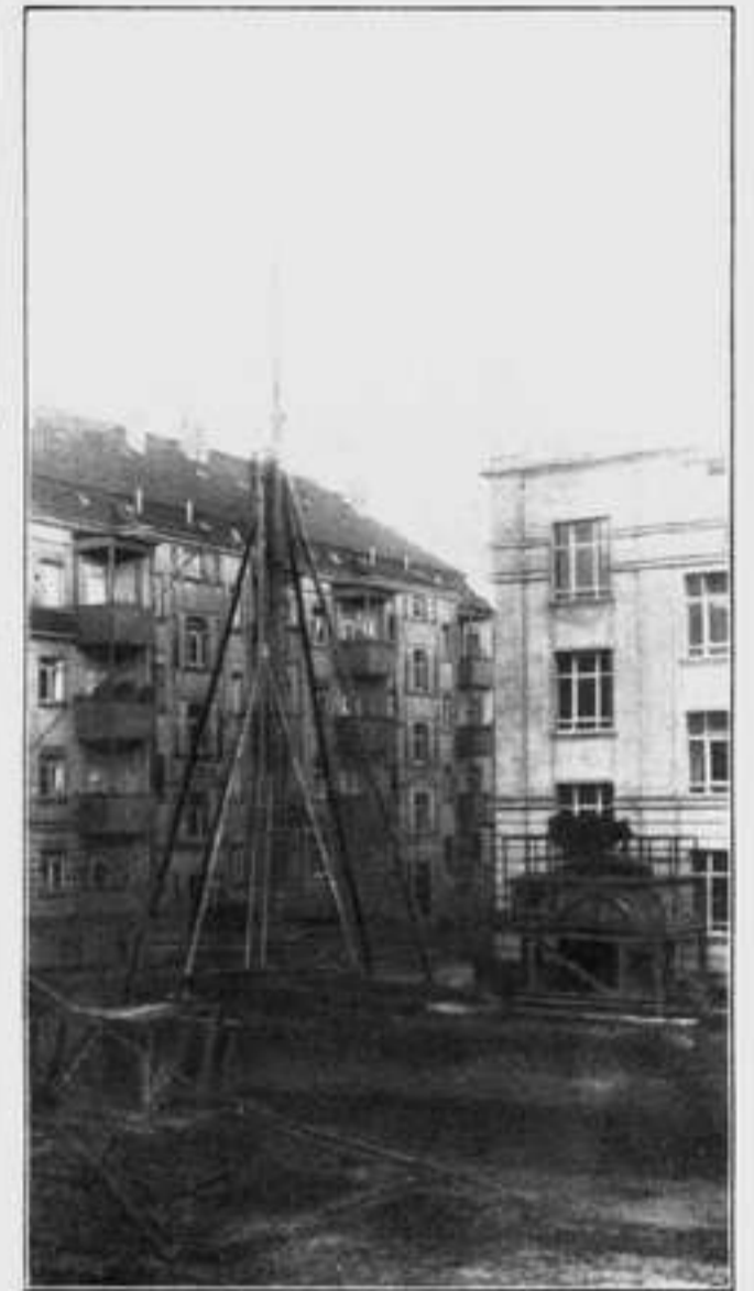
Aufbau des Hilfskrans zum Aufbau des Transportkrans. Rechts das Untergerüst auf Rädern.
