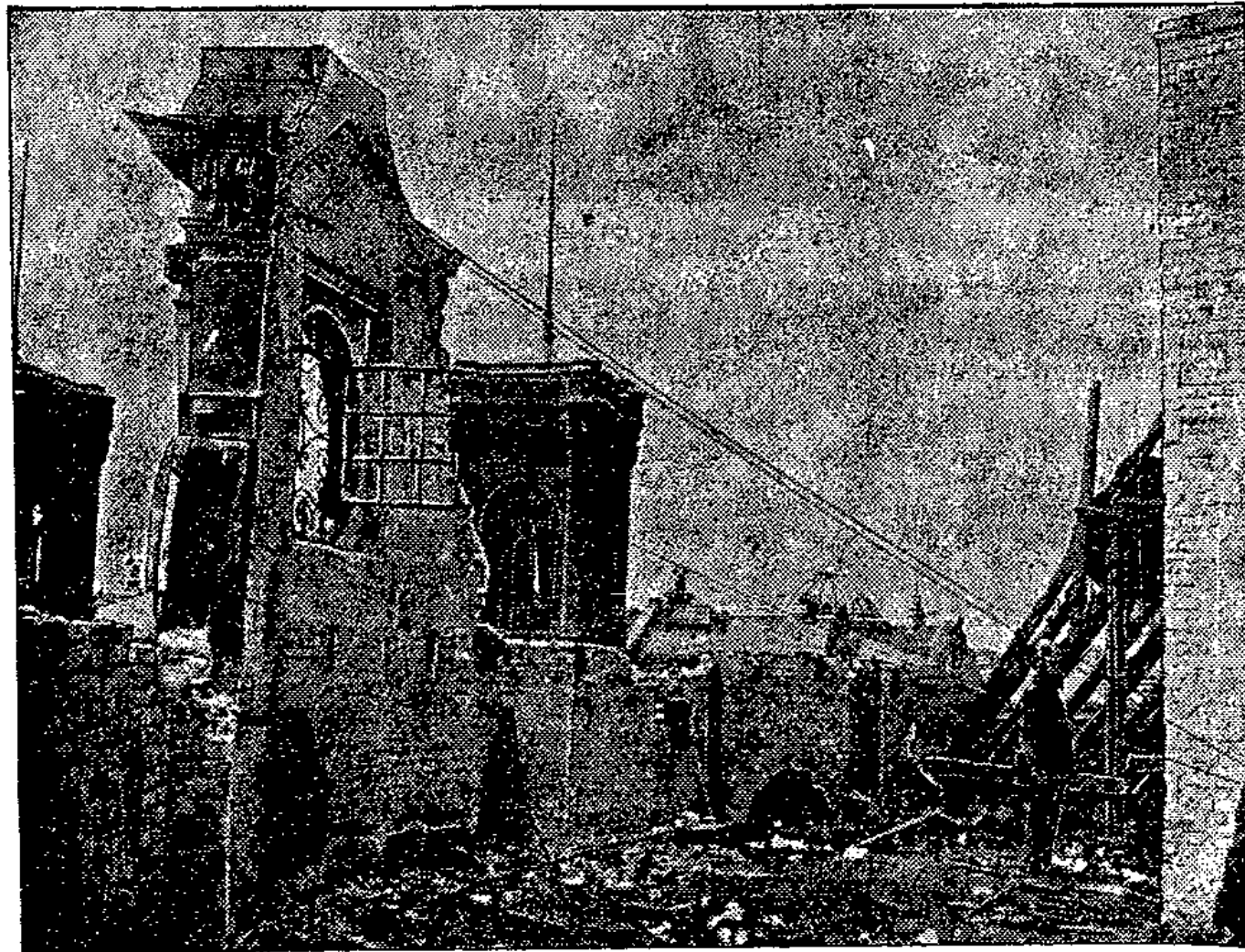
Ein völlig niedergebrannter Dachstuhl in Berlin-Mit-Moabit
