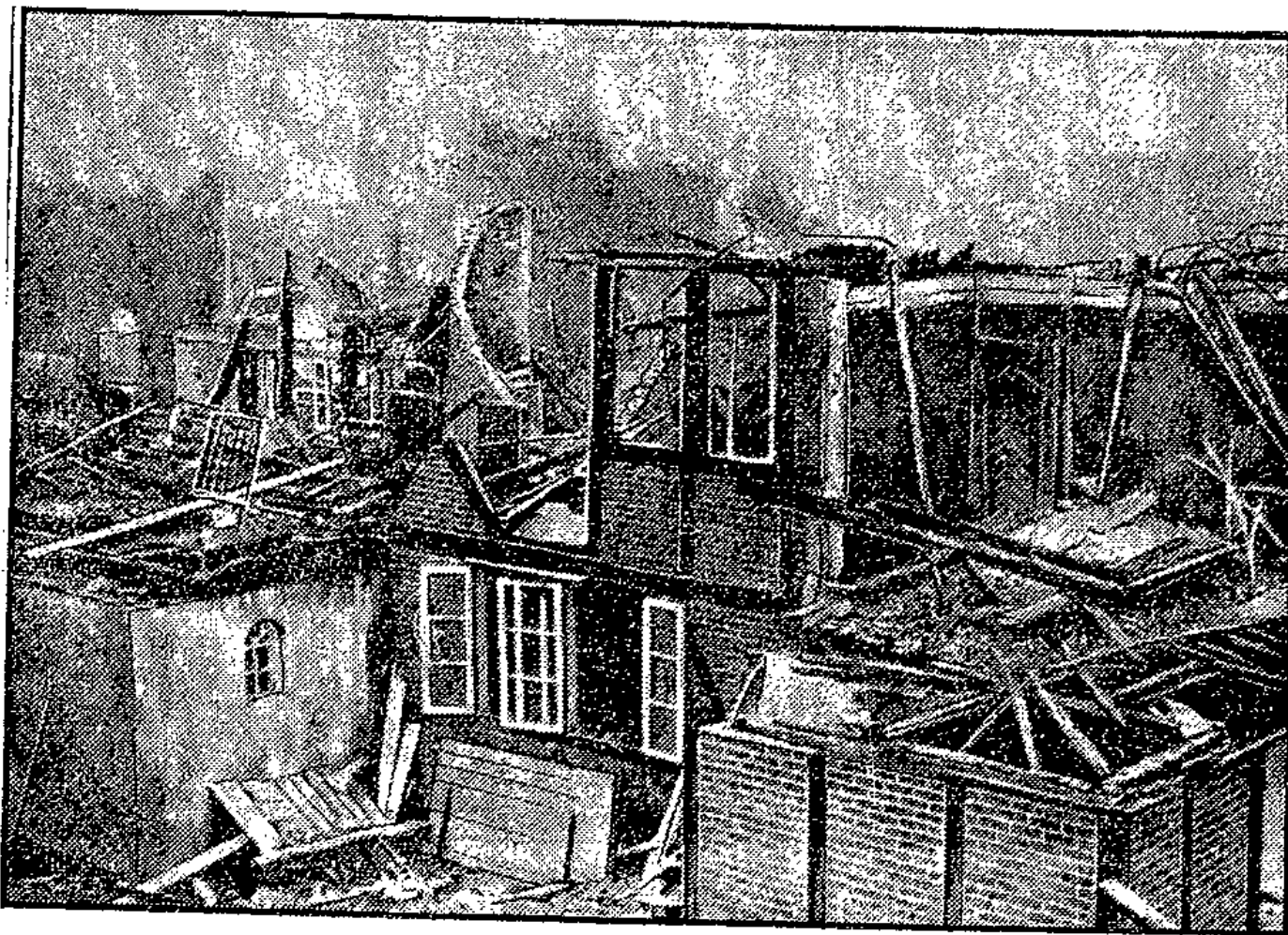
Das Berufserziehungsheim nach dem Brande. In dem Berufserziehungsheim in Hülkel brach ein Feuer aus, das sich zu einer Katastrophe auszuweiten drohte, da 140 Kinder in dem Gebäude schliefen. Nur der Umsicht der Aufsichtspersonen ist es zu verdanken, daß alle Kinder sicher aus dem brennenden Hause herausgeführt werden konnten.
