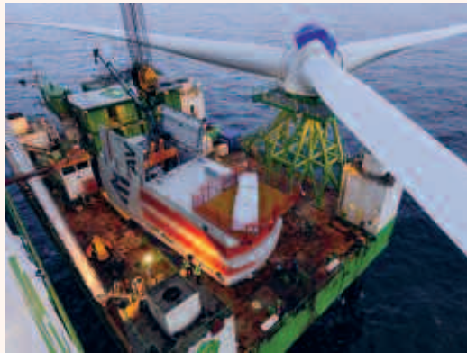
Maschinenhaus im Windpark Alpha Ventus. Foto: REpower
